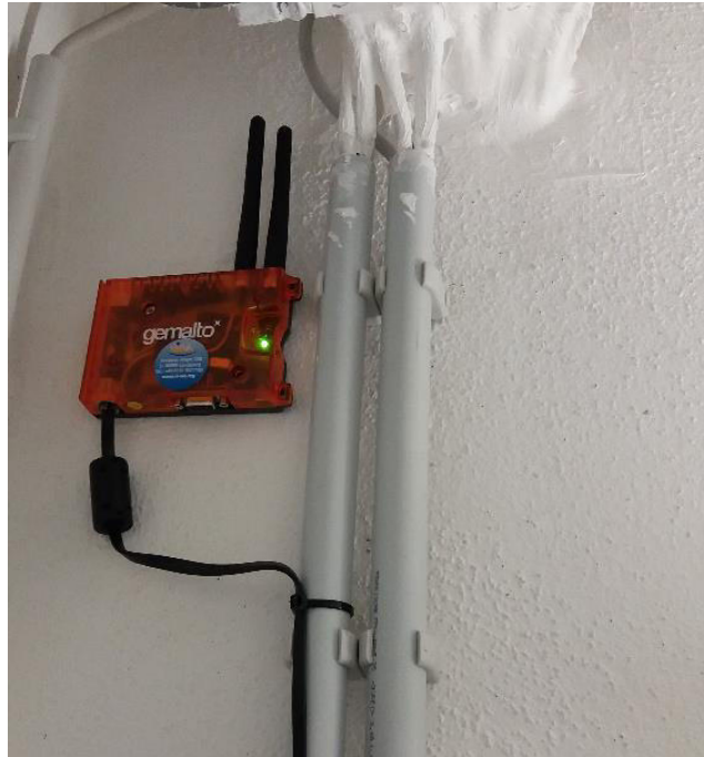
Abbildung 5 Radiomodul am Rücklauf der Heizung (oben) und Datenlogger (unten) im Keller des Verwaltungsgebäudes Sigleck Quelle: Stadt Pfaffenhofen
